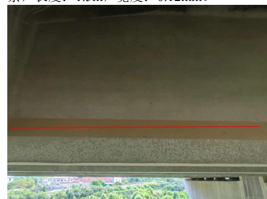
图 3-3：草板大桥（上行）9-3T 梁：距 9 号墩 2m 处，右腹板纵向裂缝；数量：1 条，长度：2.5m，宽度：0.14mm。
