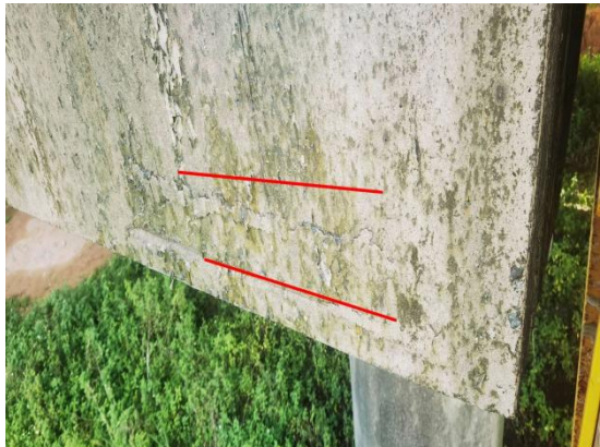
图 3-13: 九湖分离(下行) GL-13D 盖梁: 左侧露筋; 数量: 2 处, 长度: 0.4m。
