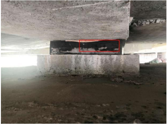
图 3-19: 草板大桥(上行) ZZ-3-2-3 支座: 横向开裂; 数量: 2 条, 长度: 0.1m, 宽度: 2mm。
