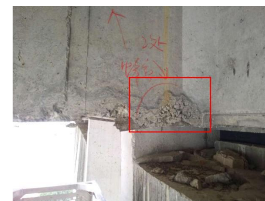
图 3-6：东园特大桥（下行）9-1T 梁：距 8 号墩 0m 处，马蹄左侧面蜂窝、麻面；数量：1 处，长度：0.15m，宽度：0.15m。
