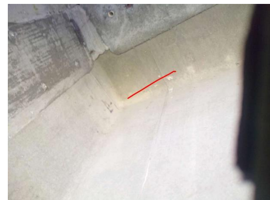
图 3-2：草板大桥（下行）5-4T 梁：距 4 号墩 0m 处，右翼缘板斜向裂缝；数量：1 条，长度：0.5m，宽度：0.12mm。
