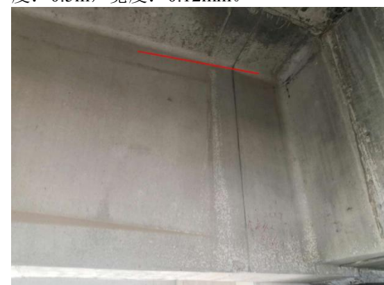
图 3-4：草板大桥（上行）10-6T 梁：距 11 号墩 0m 处，右翼缘板纵向裂缝；数量：1 条，长度：0.5m，宽度：0.12mm。
