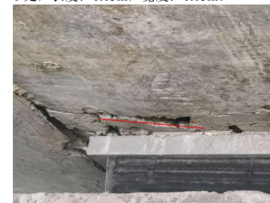
图 3-8：东园特大桥（上行）3-2T 梁：距 3 号墩 0m 处，梁底露筋；数量：1 处，长度：0.1m。
