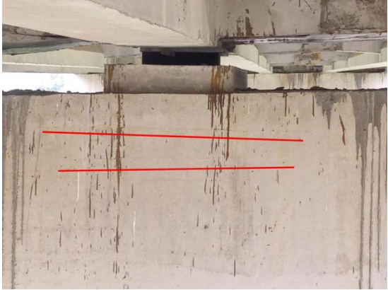
图 3-16: 石华大桥(上行) GL-12D 盖梁: 距左侧 3m 处, 距上缘 0.3m 处, 大桩号面胀裂剥落; 数量: 2 处, 长度: 1m。
