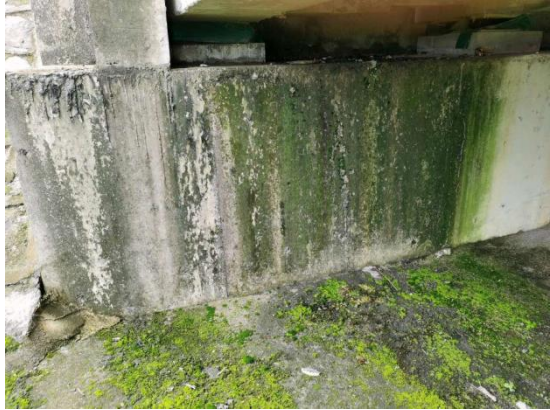
图 3-15: 漳州南互通主线桥(上行) TM-0T 台帽: 渗水泛碱。
