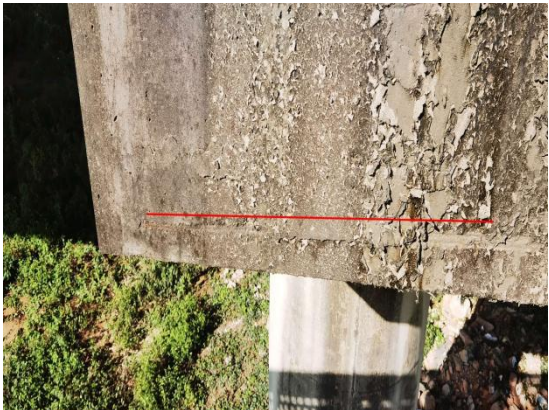
图 3-14: 九湖分离(上行) GL-17D 盖梁: 右侧挡块胀裂剥落; 数量: 1 处, 长度: 1m。
