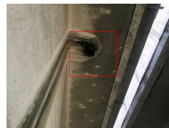
图 3-5：草板大桥（上行）10-6T 梁：距 11 号墩 5m 处，左翼缘板剥落；数量：1 处，长度：0.3m，宽度：0.25m。
