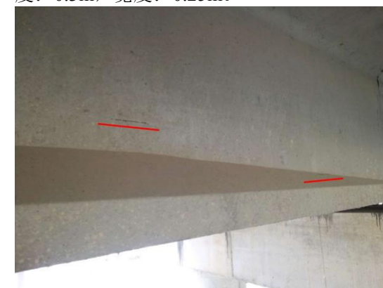
图 3-7：东园特大桥（下行）11-3T 梁：距 11 号墩 2m 处，右腹板露筋；数量：2 处，长度：0.2m。
