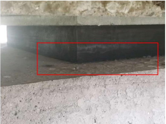
图 3-18: 东园特大桥(下行) ZZ-7-6-6 支座: 脱空; 数量: 1 个, 百分比: 20%。
