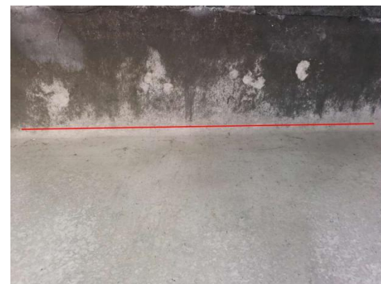
图 3-1：草板大桥（下行）3-5T 梁：距 3 号墩 2m 处，翼板与腹板交接处纵向裂缝；数量：1 条，长度：1.5m，宽度：0.12mm。
