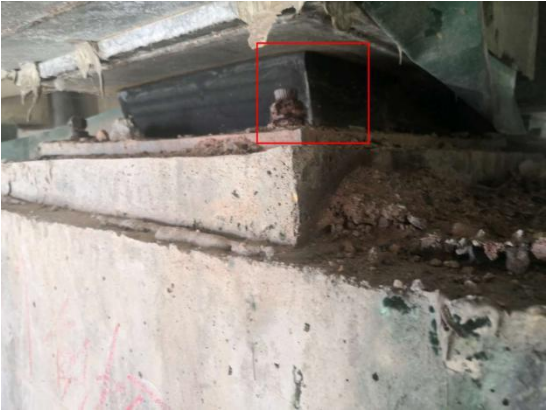
图 3-20: 草板大桥(上行) ZZ-14-13-5 支座: 纵向剪切; 数量: 1 个, 角度: 30°。
