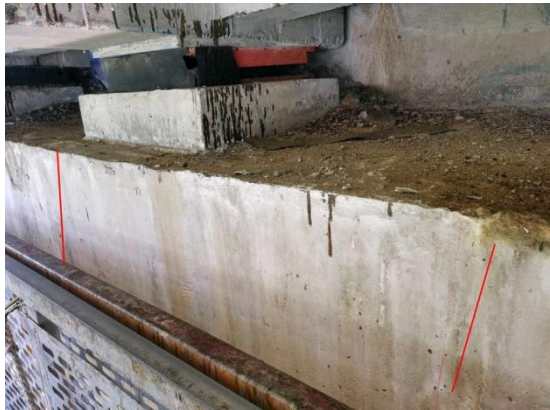
图 3-11: 石华大桥(下行) TM-18T 台帽: 距左侧 3m 处, 台帽竖向裂缝; 数量: 2 条, 长度: 0.5m, 宽度: 0.13mm。
